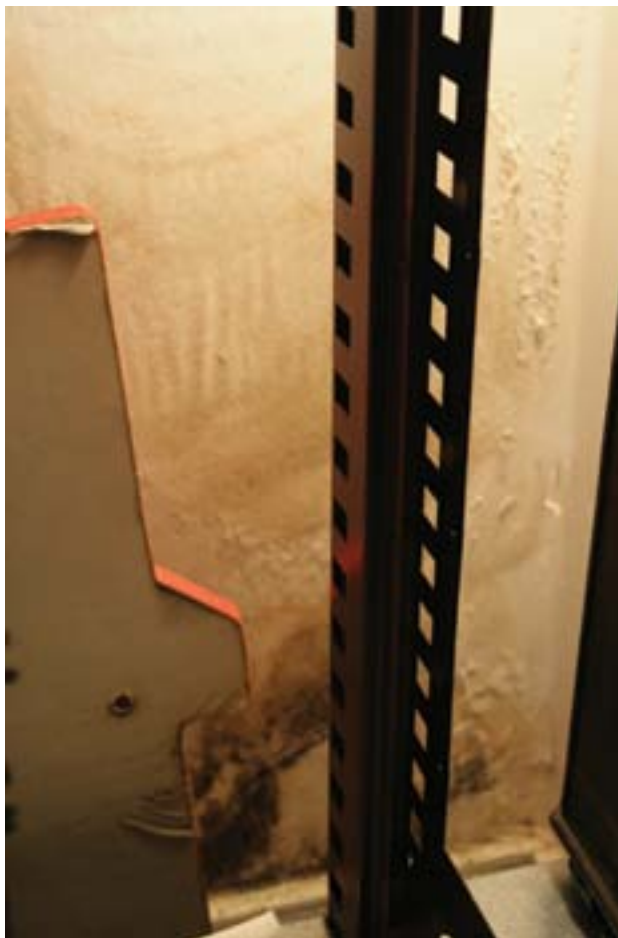
In juli werd het museum opgeschrikt door ernstige waterschade in het collectiedepot. Gelukkig is er geen collectie beschadigd geraakt. Na lang zoeken bleek de lekkage veroorzaakt door een verstopte inpandige hemelwaterafvoer. Voor het herstel moest het depot deels worden ontruimd en een deel van de natte muur worden vervangen.
